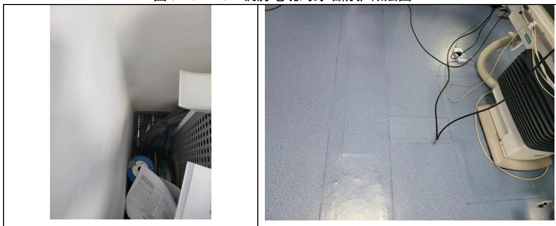
图 3-17 验收时电缆沟现场照片
